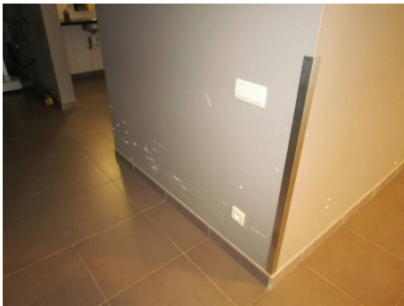
Hoekbescherming met inox hoekprofiel. Dit is niet voldoende om ook de naastgelegen wand te beschermen.
