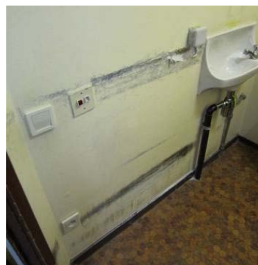
Wandbeschadiging door voetsteunen en joystick van de rolstoel. Eigen thuis vzw, © Enter vzw
