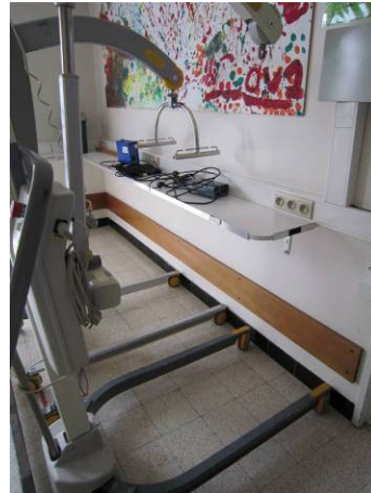
Laadpunt met meerdere stopcontacten per plaats.
