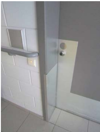
Deuren waar enkel personeel toegang toe heeft zijn voorzien van een badgelezer en kruk. Mané vzw, © Enter vzw
