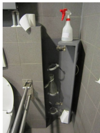
Opbergkast aan de toiletspot voor urinaals.
