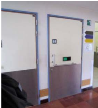
L-vormige greep aan de deur van het toilet. Hoge inox beschermplaat.
