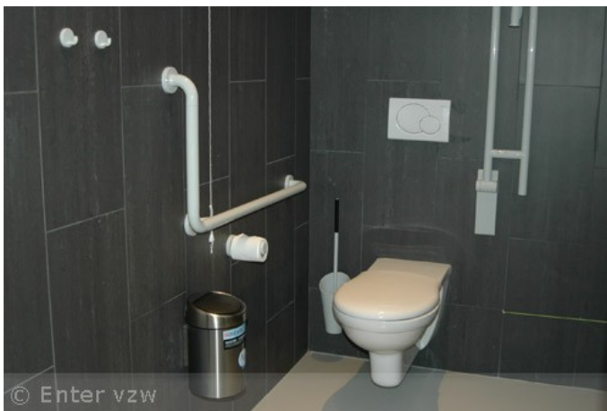
Aangepast toilet voor personen met een beperking. Enter vzw, © Enter vzw
