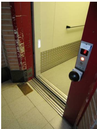
Beschadiging van de lift door een te smalle toegang. Aangepaste oproepknop aan de buitenzijde van de lift.
