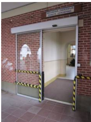
Bescherming van de glazen deur: ijzeren kader met waarschuwingsmarkering. St. Lodewijk vzw, © Enter vzw
