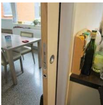
Schuifdeur met een ingewerkte greep die zeer moeilijk te gebruiken is! Zorgcentrum Maria - Ter - Engelen vzw, © Enter vzw
