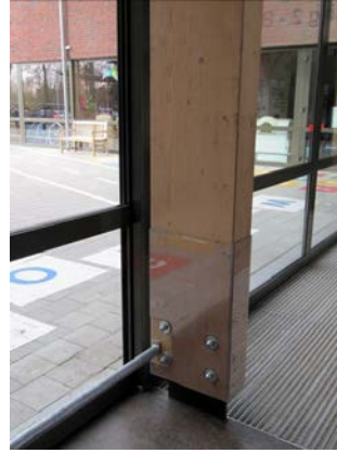
Plexi plaat en stalen stang ter bescherming van kolommen en glazen wanden.
