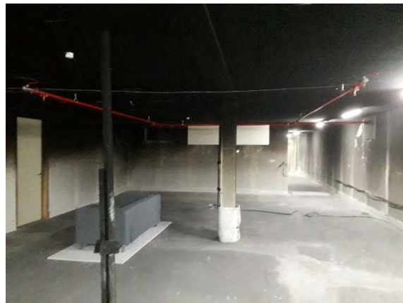
Locatie sprinklerkop t.o.v. de brandhaard
