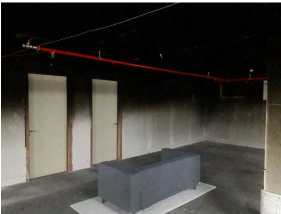
Locatie sprinklerkop t.o.v. de brandhaard
