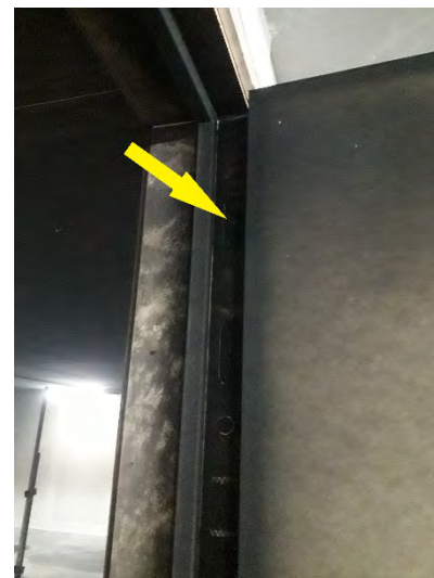
Brandwerende deur ("zwarte" omlijsting rechts naast aanslag)
