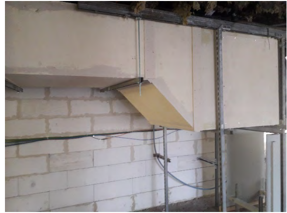
Overgang rechthoekig kanaal naar ventilator
