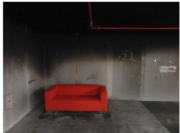
Sprinkler ter plaatse van de brandhaard
