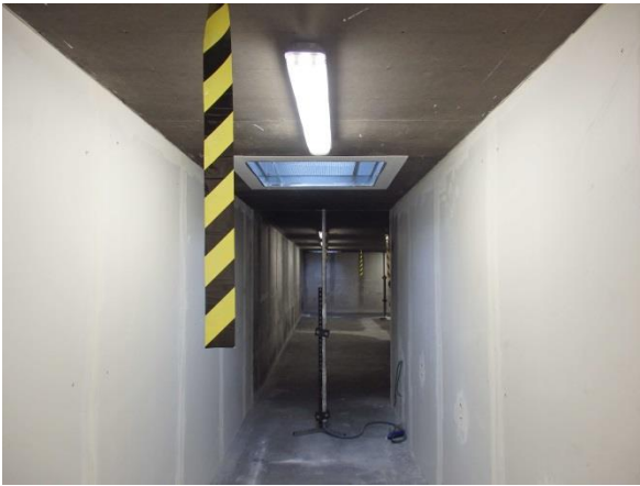
Toevoerventilator in Gang1
